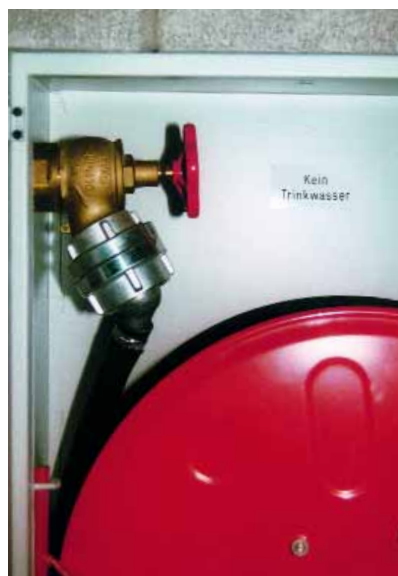
Abb. 150 Fachhochschule in Remagen, Wandhydrant mit Regenwasser
